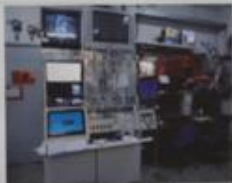
Fig. 1. Painel de controle - LPT
